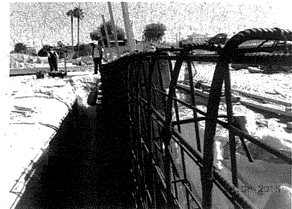
Fotografía N° 12: Enfierradura de muro de contención del tramo 2 con gran presencia de óxido.
