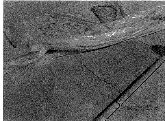
Fotografía N° 8: Pavimento de hormigón pigmentado de la ciclobanda se encuentra agrietado.
