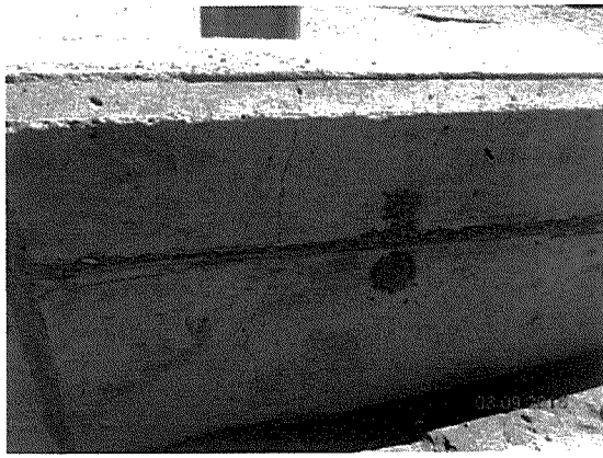
Fotografía N° 25: Muro de contención M8 agrietado.
