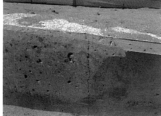
Fotografía N° 24: Muro de contención M1 agrietado.
