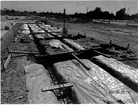
Fotografía N° 13: Enfierradura de fundaciones de los sombreaderos con gran presencia de óxido.
