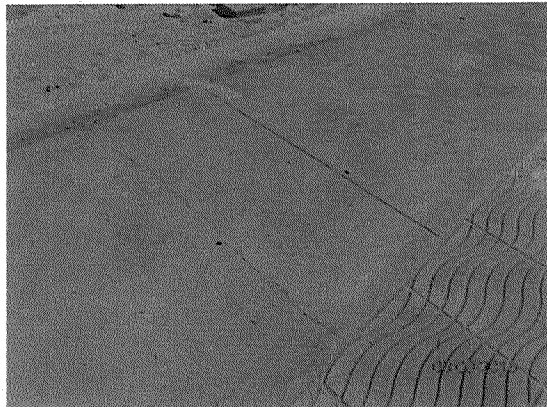
Fotografía N° 18: Pavimento de hormigón a la vista agrietado.
