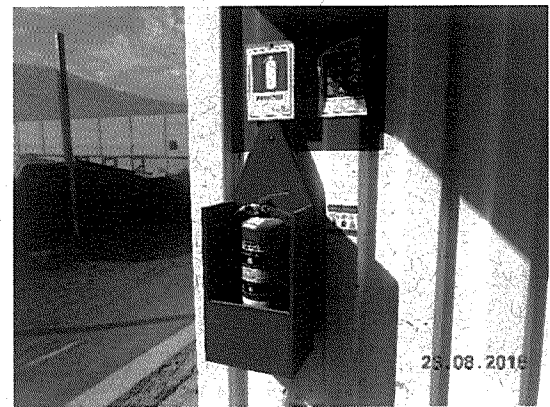
Fotografía N° 29: Extintor a la intemperie en la instalación de faena, sin puerta de vidrio en su gabinete.
