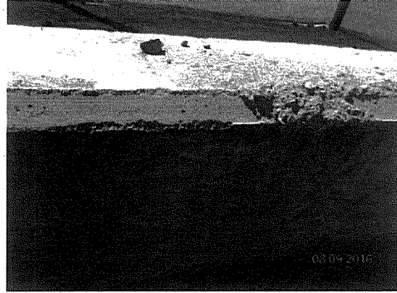
Fotografía N° 22: Muro de contención M1 agrietado.
