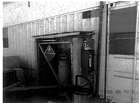
Fotografía N° 30: Extintor a la intemperie en la instalación de faena, sin puerta de vidrio en su gabinete.
