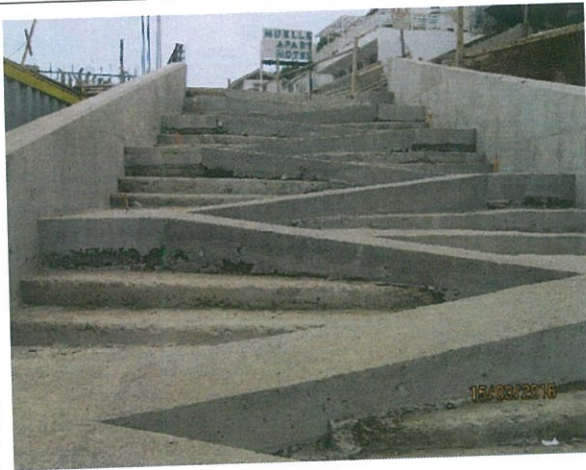
Fotografía N° 1 – 15/03/2016: Rampa de acceso no considera pasamanos continuo de 0,95m de altura.
