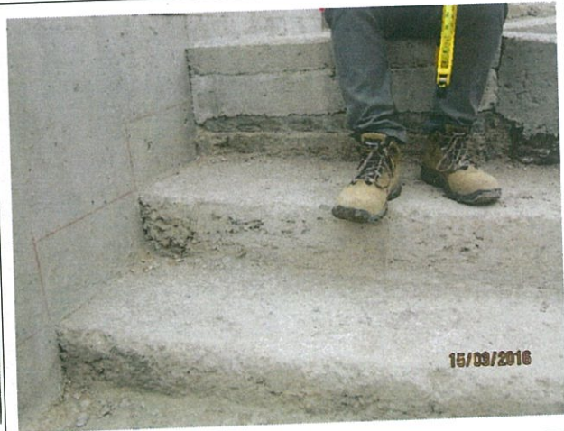
Fotografía N° 4 – 15/03/2016: Altura de contrahuella no se ajusta a normativa.
