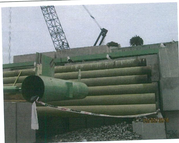
Fotografía N° 9 – 15/03/2016: Pilotes metálicos suministrados con esquemas de protección anticorrosiva incompletos
