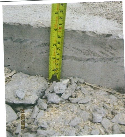
Fotografía N° 6 – 23/03/2016: Lo instalado para recibir a radier H-25 e=10cm, no se condice con la cama de ripio que señala el proyecto.
