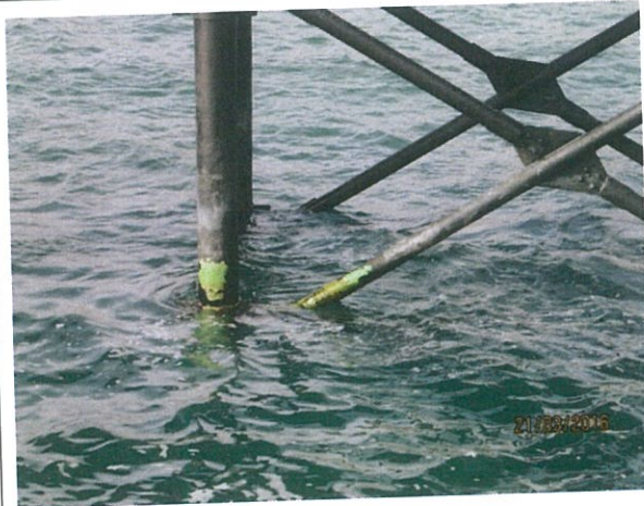
Fotografía N° 13 – 21/03/2016: Esquemas de protección anticorrosiva dañada en pilote y arriostamiento.
