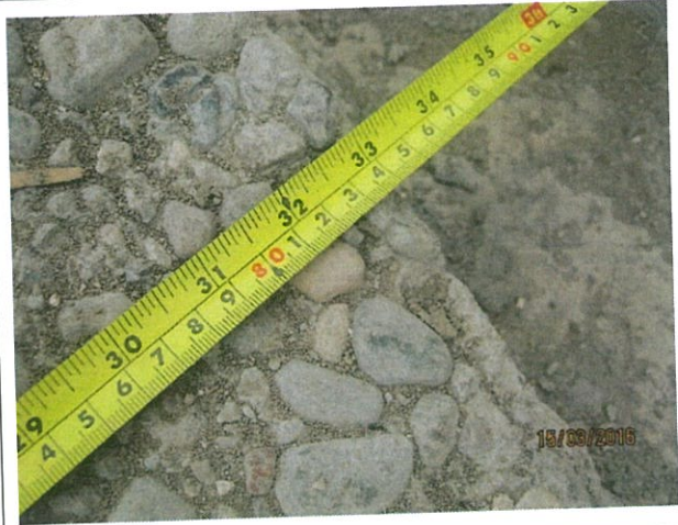
Fotografía N° 2 – 15/03/2016: En ciertos tramos no se cumple con el ancho mínimo de 0,90m establecidos en la normativa.
