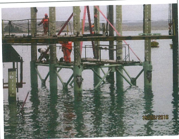
Fotografía N° 7 – 15/03/2016: Pilotes hincados con esquema de protección anticorrosiva dañado.
