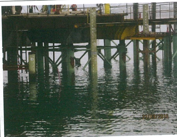
Fotografía N° 8 – 23/03/2016: Pilotes hincados con esquema de protección anticorrosiva dañado
