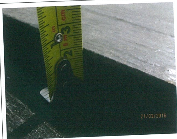
Fotografía N° 18 – 21/03/2016: Altura de junta de dilatación sobrepasa los 12 mm que considera el proyecto.
