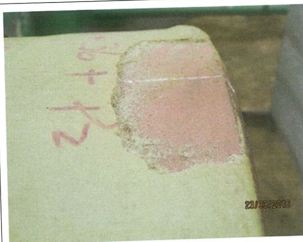
Fotografía N° 10 – 23/03/2016: Pilotes metálicos suministrados con esquemas de protección anticorrosiva dañados.
