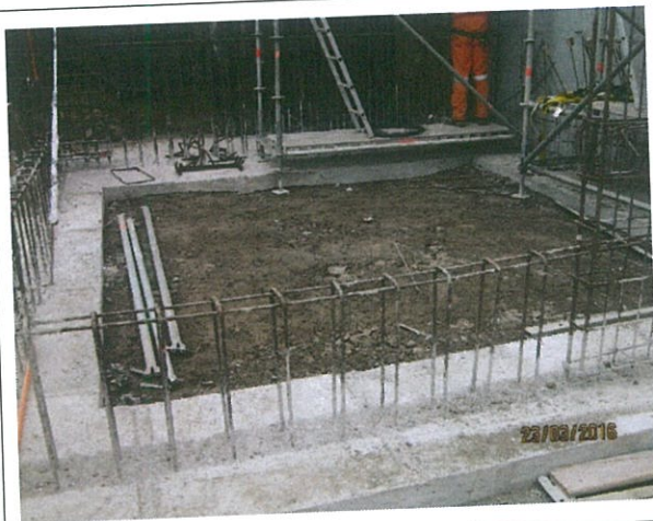
Fotografía N° 5 – 23/03/2016: No se ejecutó la instalación de la cama de ripio
