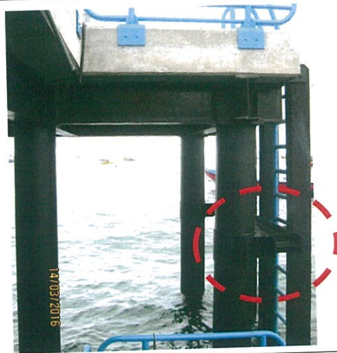
Fotografía N° 14 – 14/03/2016: Abrazadera que sostiene viga portadefensa no se ajusta a proyecto.
