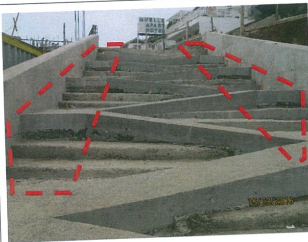
Fotografía N° 3 – 15/03/2016: Ancho útil de escaleras construidas no cumplen con ancho mínimo de una vía de evacuación.
