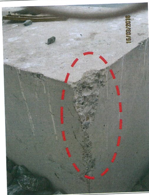
Fotografía N° 12 – 15/03/2016: Bloque de hormigón con deficiencias.
