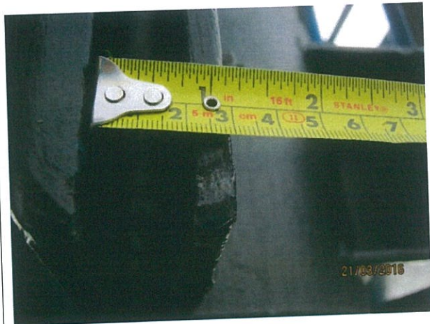
Fotografía N° 16 – 21/03/2016: Separación de 20 mm entre elementos que conforman abrazadera.
