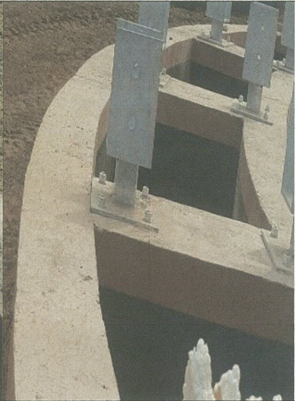
Fotografía N° 39, junta de dilatación entre vértices 117 y 118, 5 de mayo 2016.
