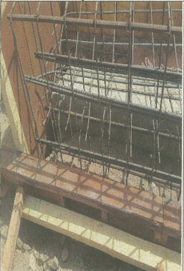
Fotografía N° 48, barras re-dobladas, 5 de mayo 2016.
