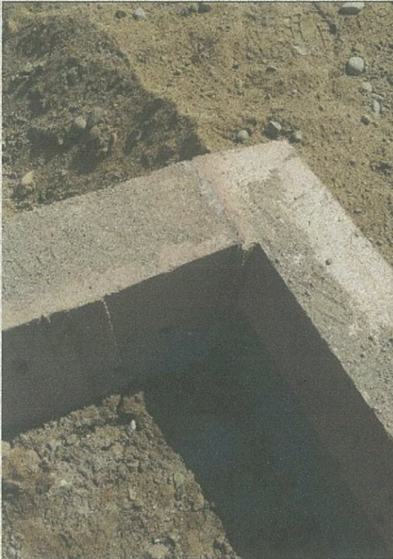
Fotografía N° 38, junta de dilatación entre vértices 101 y 102, 5 de mayo 2016.
