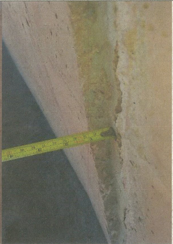
Fotografía N° 4, muro i4, entre vértices 74 y 77, 28 de abril 2016.
