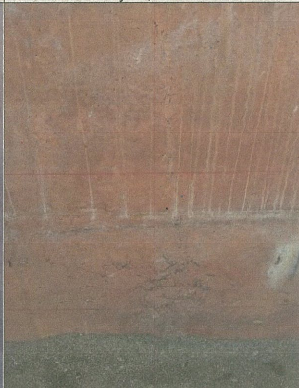
Fotografía N° 25, inferior muro entre vértices 79 y 80, 5 de mayo 2016.
