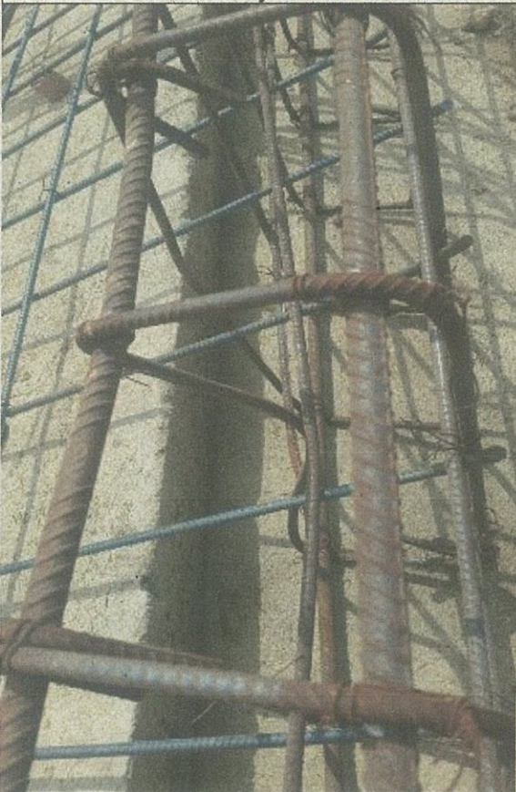
Fotografía N° 47, barras deformadas, 5 de mayo 2016.
