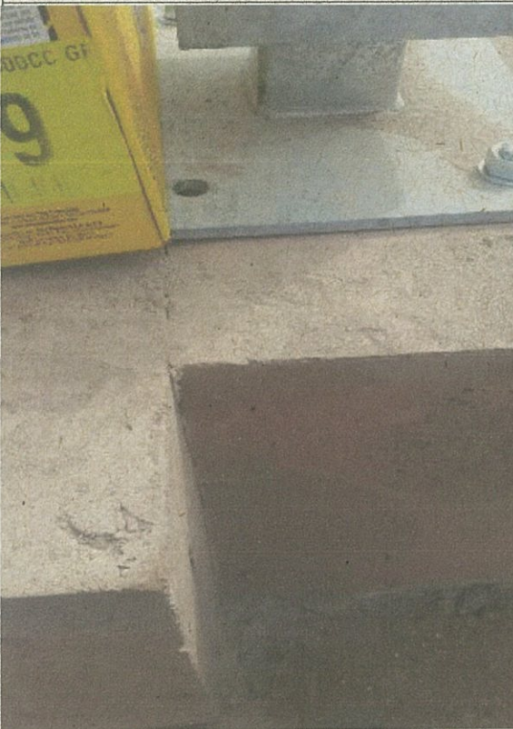
Fotografía N° 40, junta de dilatación entre vértices 117 y 118, 5 de mayo 2016.
