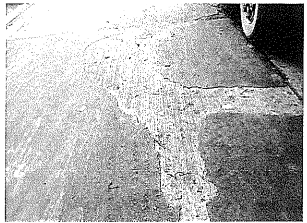
Fotografía N°10: Pavimento con desprendimiento superficial en zona 3. "Reparación obras portuarias Caleta Puertecito, San Antonio"
