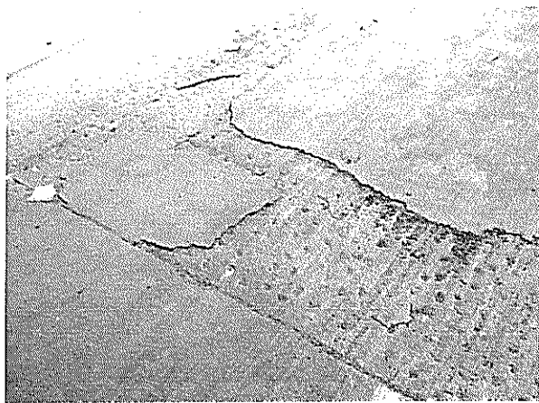
Fotografía N°9: Pavimentos con desprendimiento superficial en zona 4. "Reparación obras portuarias Caleta Puertecito, San Antonio"
