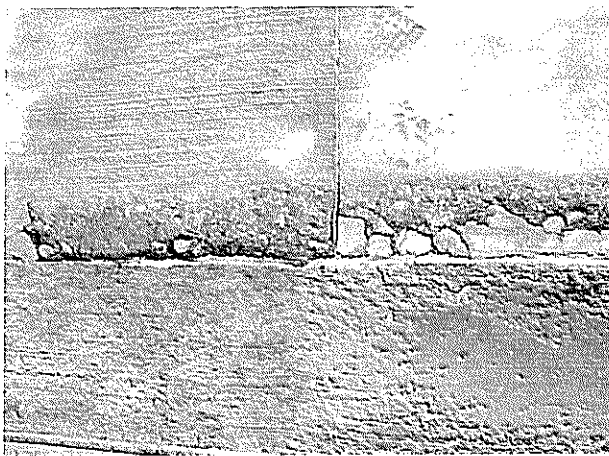
Fotografía N°11: Deficiencia en junta de hormigon. "Reparación obras portuarias Caleta Puertecito, San Antonio"
