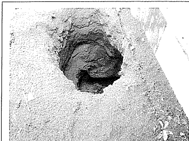
Fotografía N° 13: Sector Estero, hundimiento de terreno en borde del muro.
