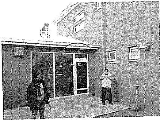
Fotografía N°9: Falta instalación de foco proyector perimetral sobre acceso a sala multiuso.
