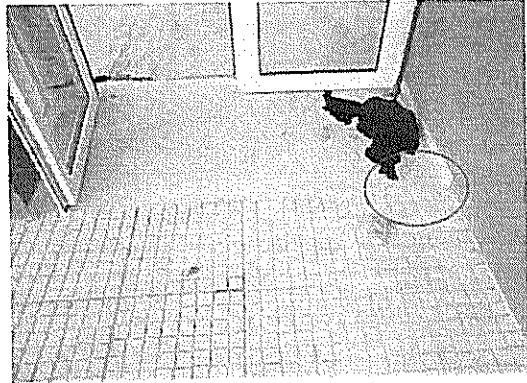
Fotografía N°8: Falta tope de goma en puertas de acceso al edificio de oficinas.
