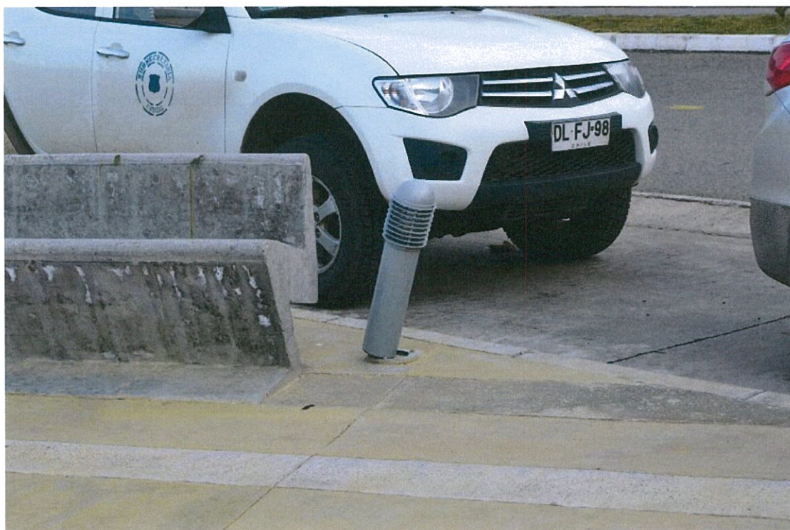
Fotografía N° 30: Luminarias en mal estado.
