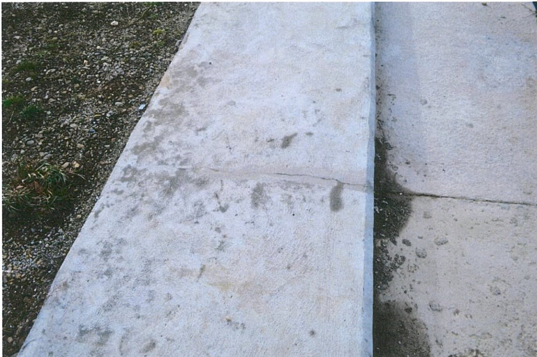
Fotografía N° 22: Fisuras en el hormigón.
