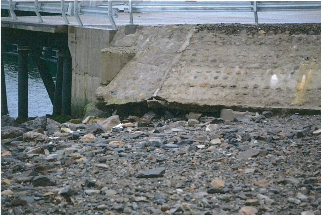
Fotografía N° 15: Socavación en el muro de la explanada.
