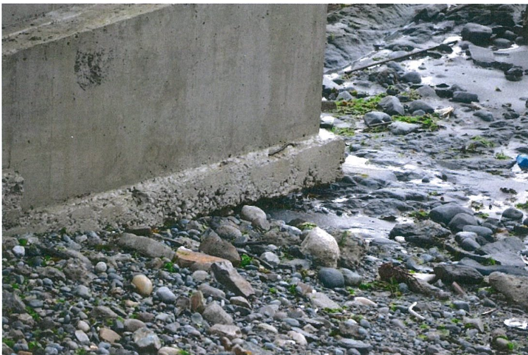
Fotografía N° 16: Socavación en la fundación de enfilación.
