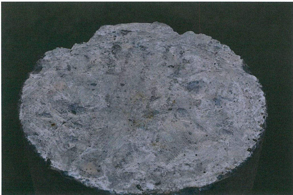
Fotografía N° 32: Superficie de pilar en mal estado
