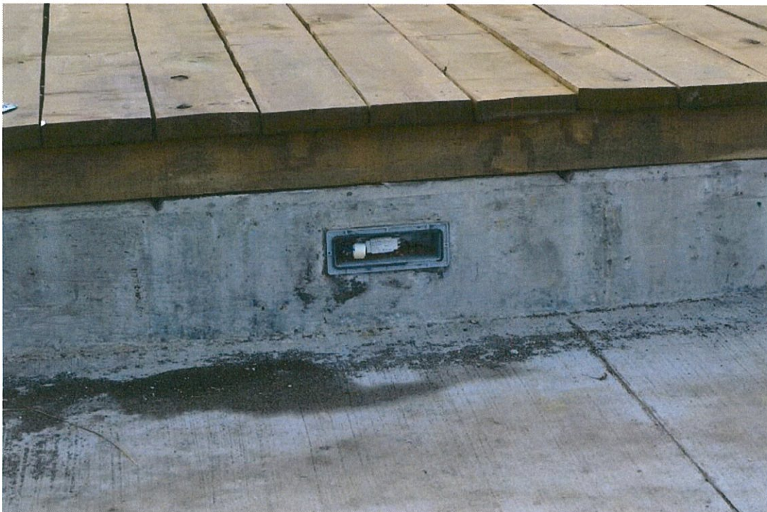
Fotografía N° 28: Luminarias en mal estado.
