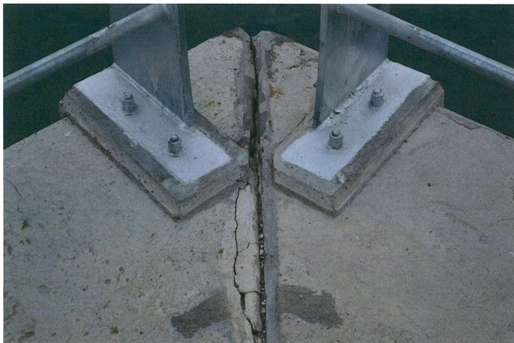
Fotografía N° 34: Fisuras en encuentro de los muros de hormigón.
