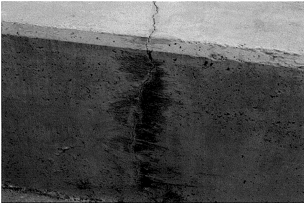
Fotografía N° 24: Fisuras en los muros.
