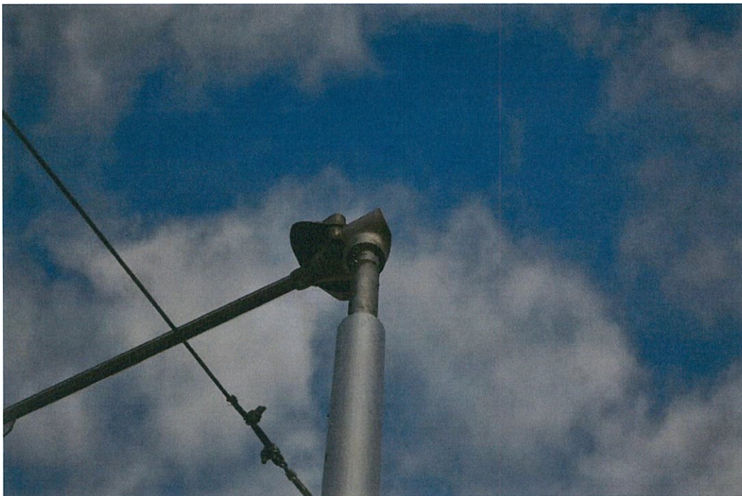
Fotografía N° 26: Generador eólico en mal estado.
