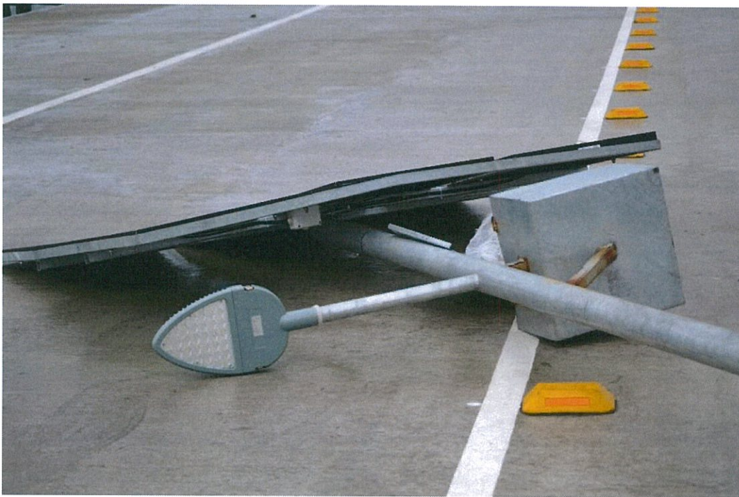
Fotografía N° 18: Caída de poste metálico de alumbrado.
