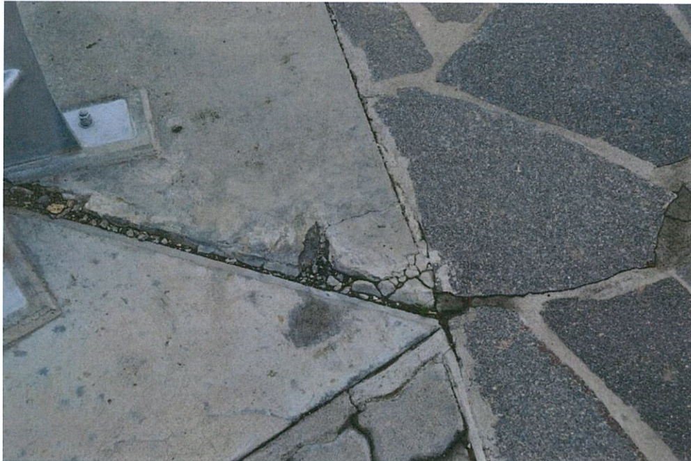
Fotografía N° 35: Desprendimiento de material en anclajes de las barandas.
