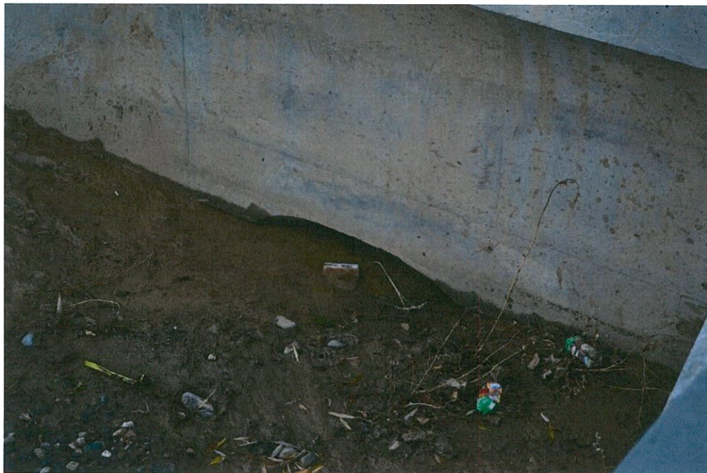
Fotografía N° 36: Ducto de desagüe obstruido por sedimentos.
