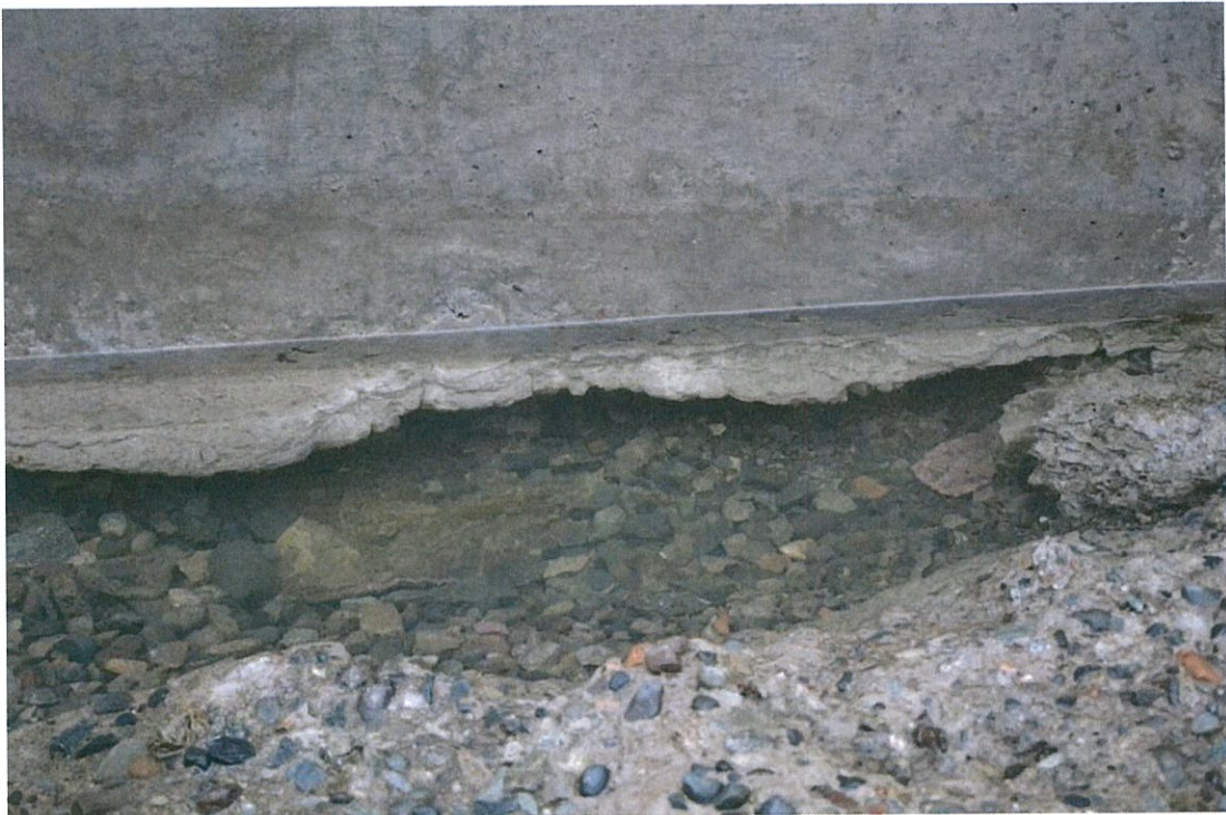
Fotografía N° 14: Socavación en el muro de la explanada.
