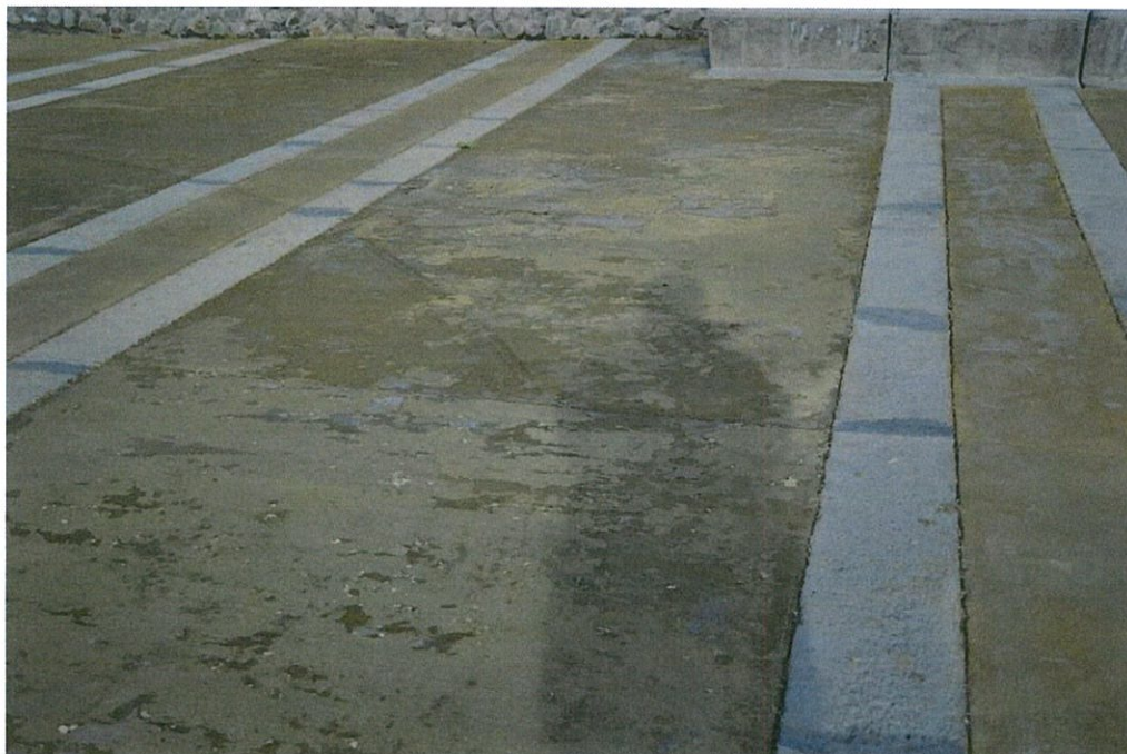
Fotografía N° 33: Daño superficial en pavimento pigmentado.
