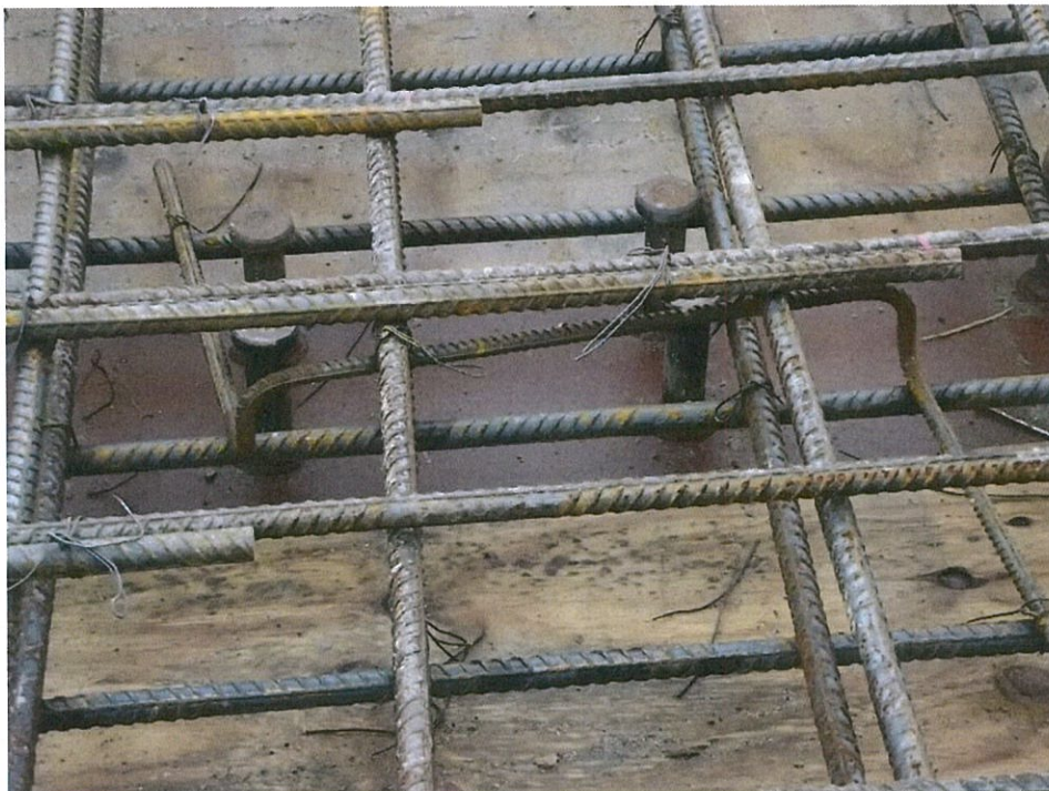
Fotografía N° 10: Evidencia de armaduras sin amarras de alambre en los encuentros.
