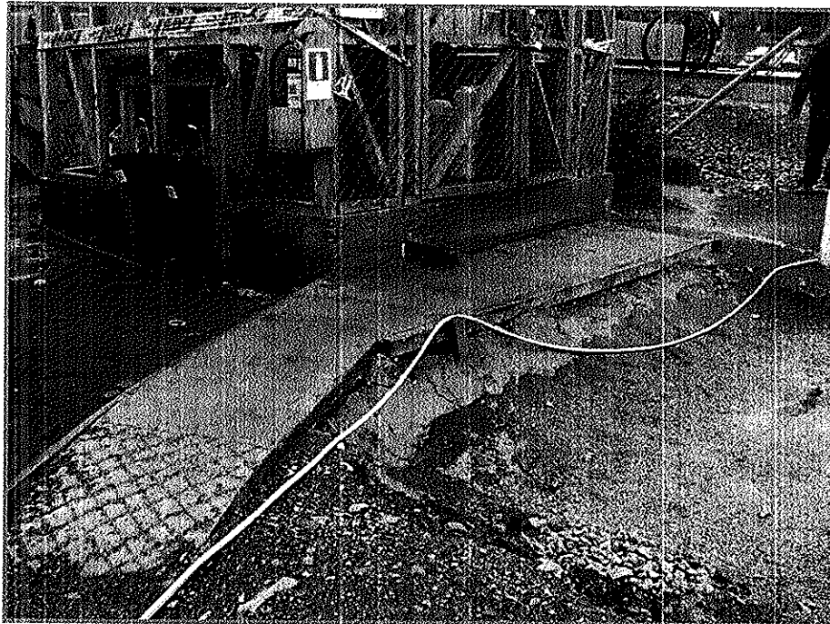
Foto N° 15. Bodega de combustibles junto a tránsito peatonal. Puerto Fuy
